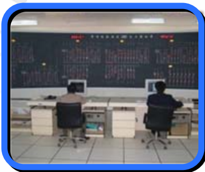
牵引供电监控 (SCADA) 系统
